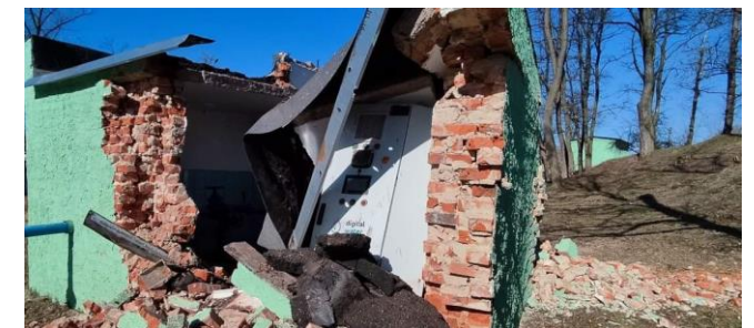
Zerstörte Wasserinfrastruktur in Tschernihiw (285.000 EW),
